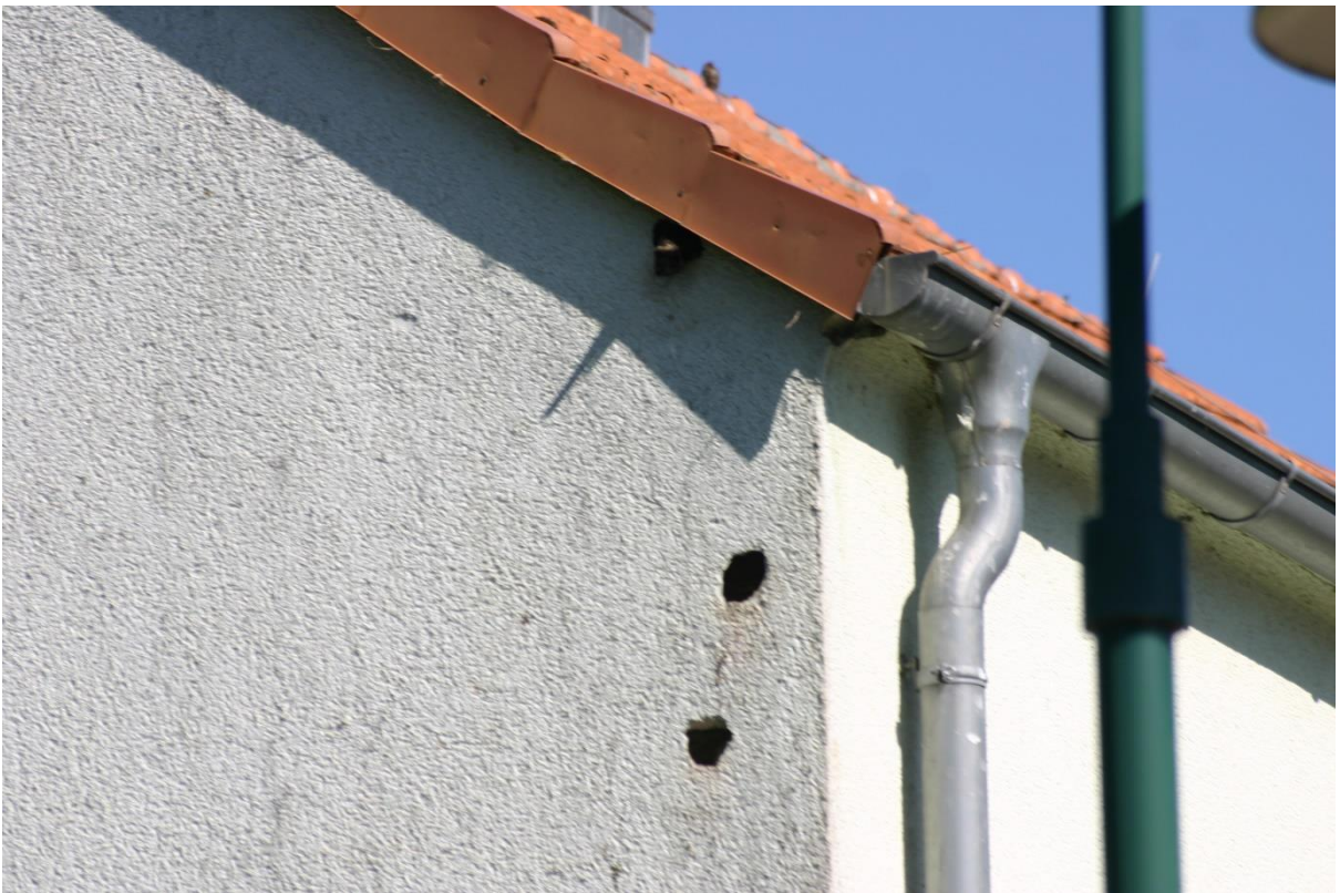
Abbildung 16: Starhöhle in Fassade im Nachbargebäude westlich gegenüber des PG
