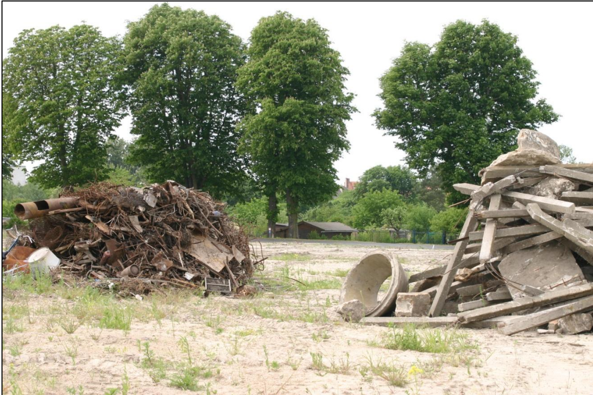
Abbildung 6: bei Baufeldfreimachung zusammengetragener Altlasten/Schutt, 22.05.2018
