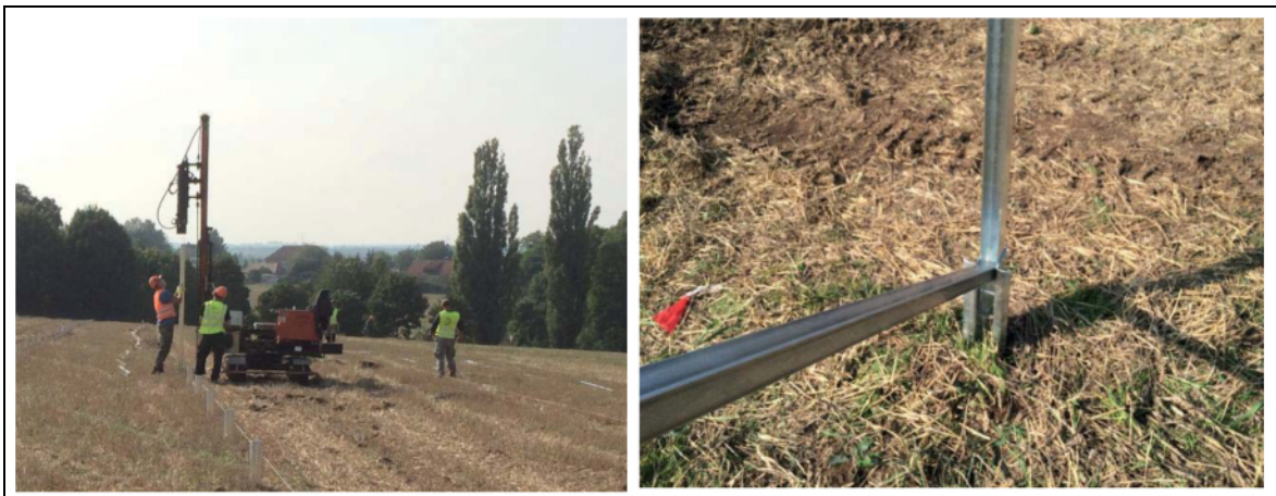
Abbildung 11 (links): der Abstand zwischen den Modulreihen wird so gewählt, dass ausreichend Platz für Montage- und Wartungsfahrzeuge ist, Abbildung 12 (rechts): Ausschnitt des möglichen Gestelltesches der Solarmodule, für die Verankerung der Module im Boden ist keine zusätzliche Versiegelung erforderlich.
