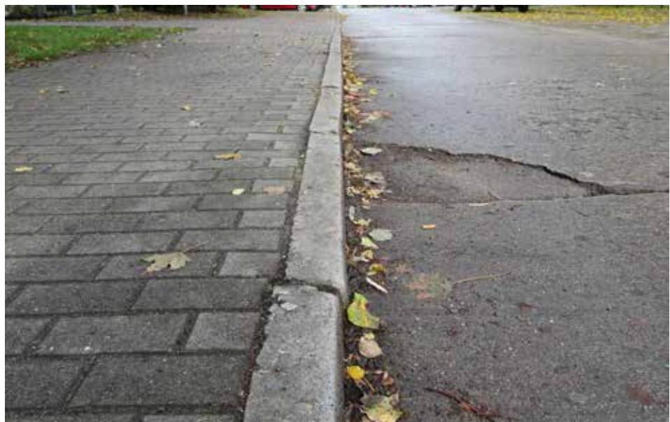
Schlechter baulicher Zustand der Straße des Friedens (Eigene Aufnahme, 2016)
