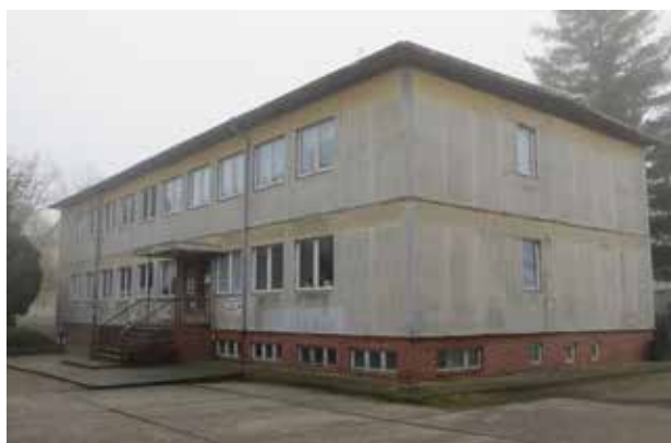
Sanierungsbedarf des „Hauses freier Träger“, Außenansicht (Stadtkümmerei, 2018)
