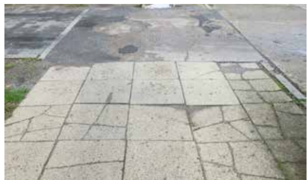
Mangelhafter baulicher Zustand von Gehwegen in der Straße des Friedens (Eigene Aufnahme, 2018)
